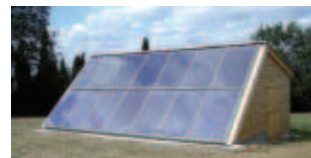
SSC sur une dépendance Photo : Gascogne Energie Solaire Marc Sarrazin
