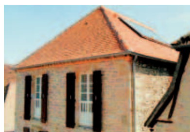
On peut observer ci-contre une installation solaire en surimposition sur une toiture inclinée, validée par un Architecte des Bâtiments de France. Cette installation se trouve en effet dans le périmètre des 500 m autour d'un bâtiment classé à Bretenoux (46)
