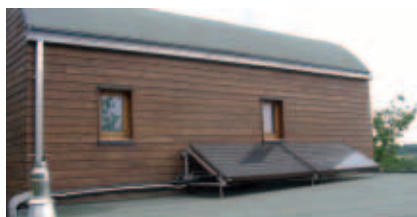
CES en toiture terrasse sur bâtiment individuel Photo : Habitat Energies - 46
