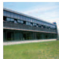
Capteurs thermiques en allège + photovoltaïque incliné en toiture (Catalogne) Photo : ARPE Midi-Pyrénées
