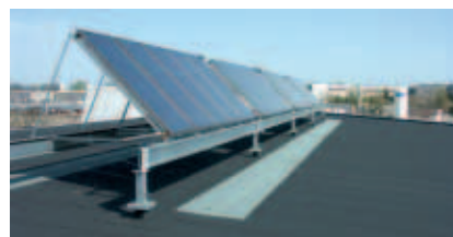
CES en toiture terrasse sur bâtiment collectif Photo : Union Climatique Frigorique
