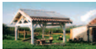
CES sur une dépendance Photo : Gascogne Energie Solaire Marc Sarrazin
